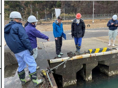
MAFF-SATによる被災状況調査
