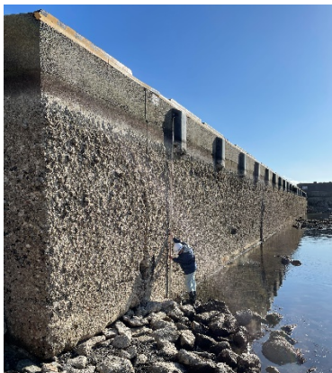
地盤隆起した鹿磯漁港
