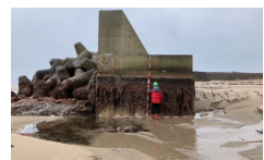
地盤隆起等の被災
