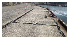
亀裂、段差等の被災
