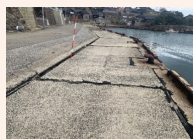
物揚場の段差（富来漁港）
