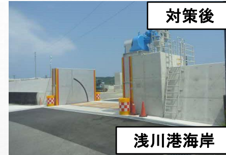
自動閉鎖式陸閘の整備
