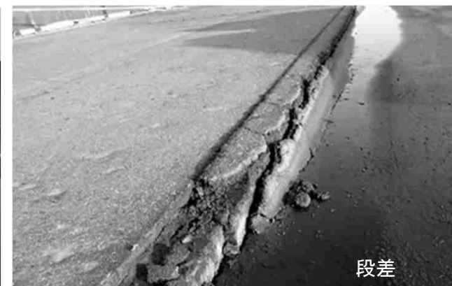
岸壁の被災(仙台塩釜港石巻港区)
