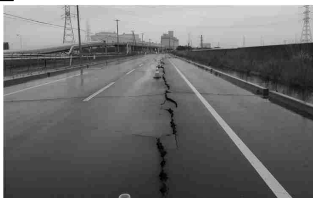
臨港道路の被災(相馬港)
