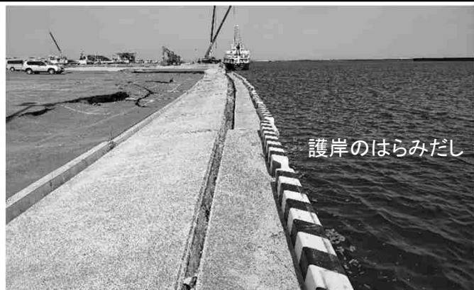
護岸の被災(相馬港)
