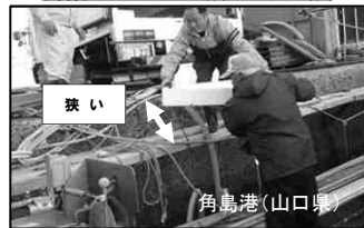
荷揚げスペース幅が狭く危険
