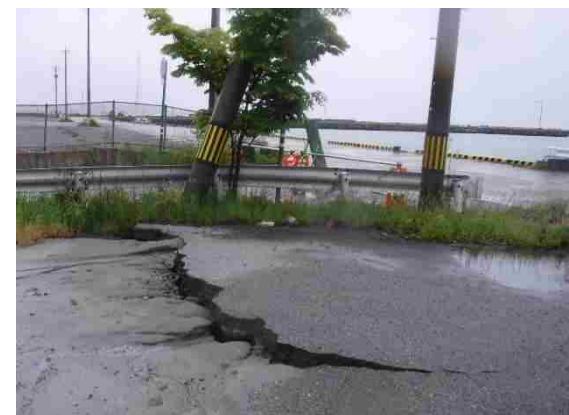
臨港交通施設の被災[飯田港(石川県)]
