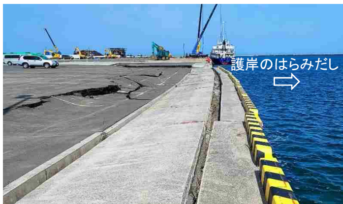
護岸の被災[相馬港(福島県)]
