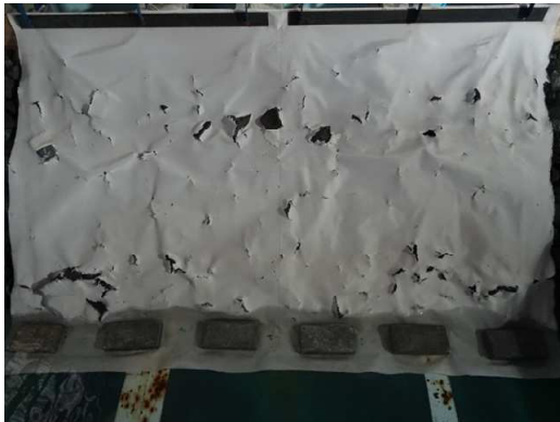
防砂シートの破損
