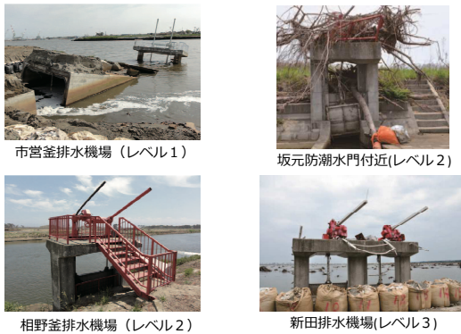
図 48 小規模水門の損傷①
