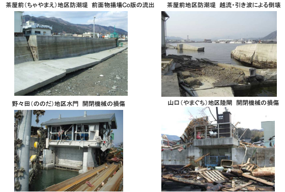
図7 海岸保全施設の被災状況 (岩手県 大船渡港海岸)
