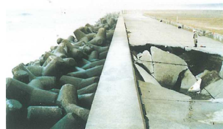
護岸の吸い出し
