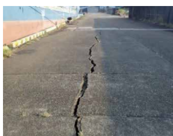
(a) 岸壁のひび割れ（油津港）
