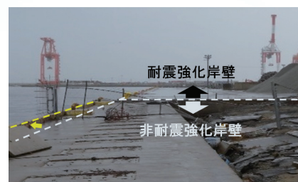
図-3 地震対策(仙台塩釜港)
