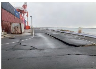
(a) 岸壁の段差・ひび割れ (八戸港)
