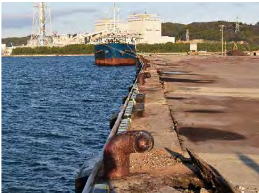
《七尾港大田岸壁の被害状況》
