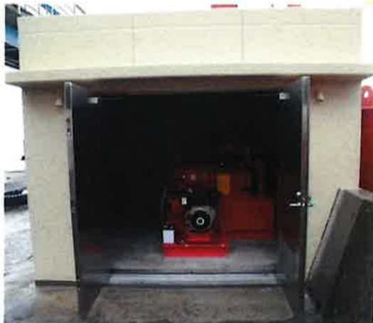
非常用電源200kVA
