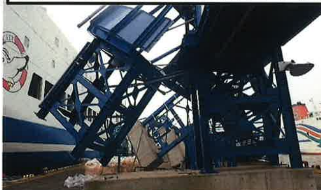
⑦ボーディングブリッジ倒壊状況 (近景)
