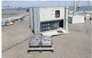
電気設備の被害 (神戸港)
