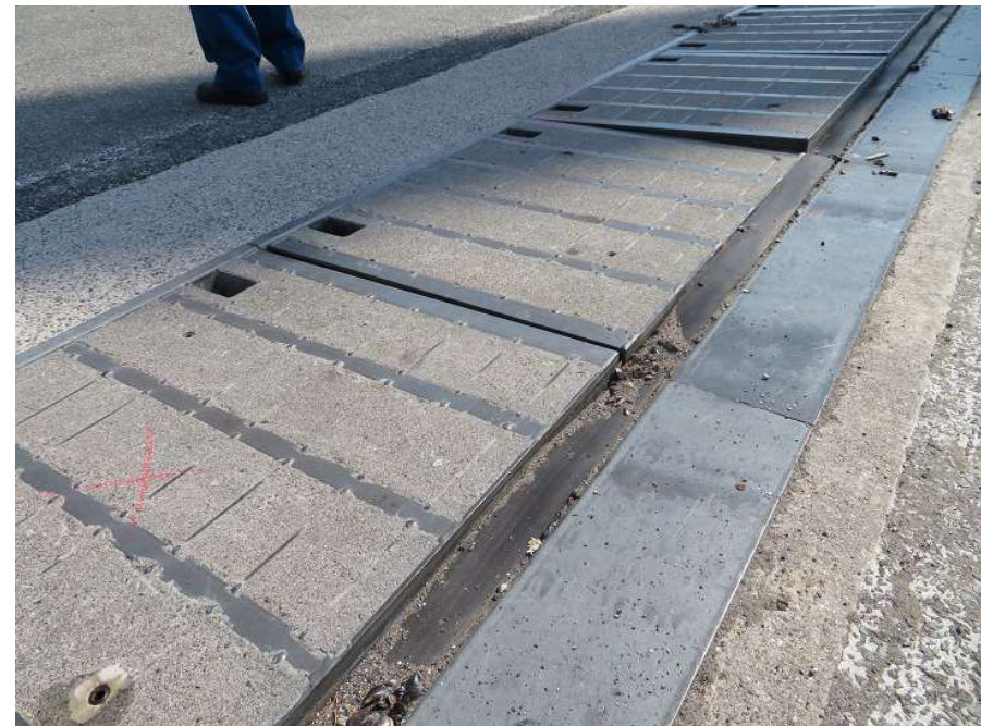
D1 渡版盛り上がり 復旧状況
