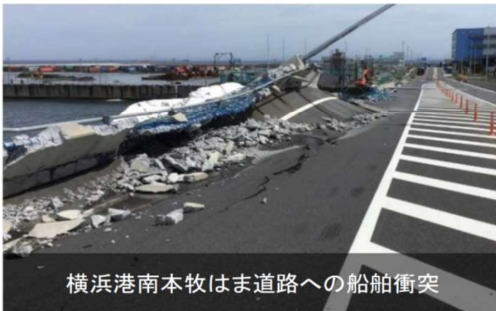
横浜港金沢区の護岸被災
