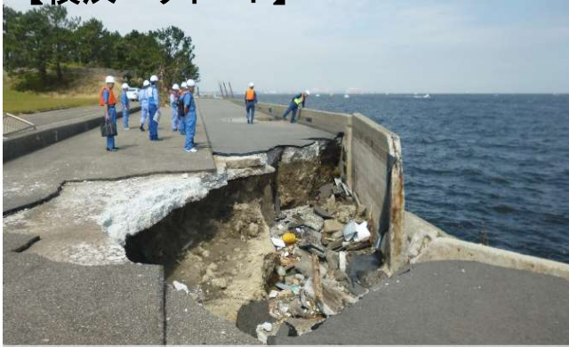
被災護岸調査状況（19/09/14時点）
