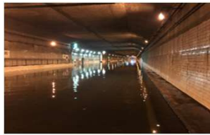
トンネルの冠水状況 (神戸港)
