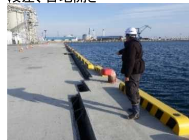
段差、目地開き
